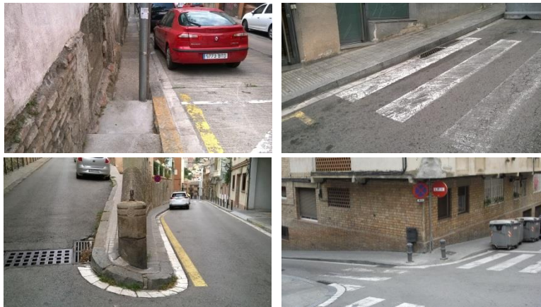
Voreres i guals no accessibles
